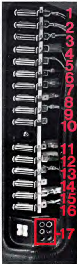
17 Hål för reservsäkringar
